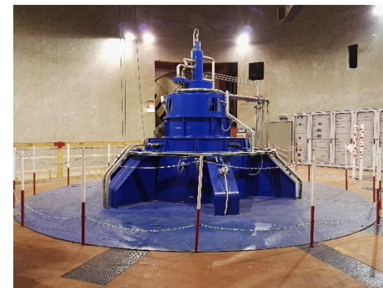
Turbina Kaplan Centrale di Uvini 17 MVA
