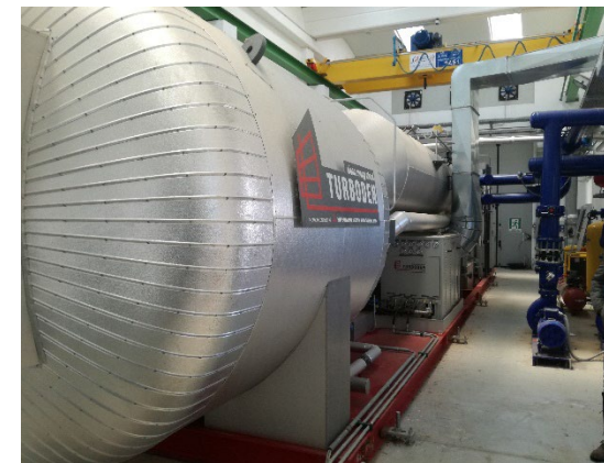
Turbina Organic Rankine Cycle impianto solare termodinamico
