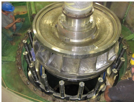
Girante turbina Francis Centrale Santu Miali 32 MVA
