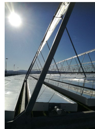
Campo specchi impianto solare termodinamico
